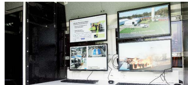
Der Transporter dient als mobile Leitzentrale. Von hier aus können die Rettungskräfte den Einsatz steuern, Lagebilder ansehen und Kontakt zu den Drohnen und Robotern halten.
